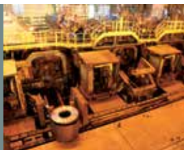
ساخت دستگاه کلاف باز کن و کلاف پیچ
